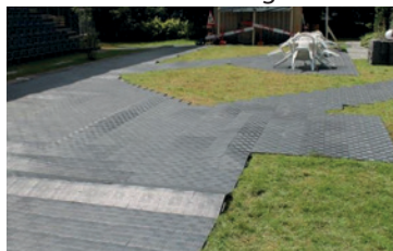
Bild 3: Falsch! Verlegung ohne Dehnungsfugen, Boden wellt sich bei Sonneneinstrahlung
